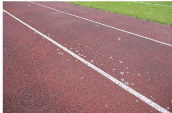
Det finnes en del mose rundt om på anlegget på flere steder, noe som tyder på for dårlig vedlikehold
