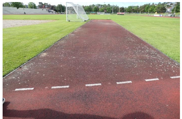
Mye mose i spydtilløpene, og friidrettsdekket er i ferd med å slippe langs kantsteinen rundt tilløpet, noe som igjen gjør at gress gror opp imellom
