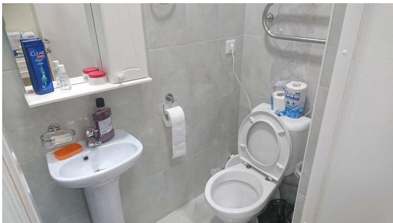
Klosettrom, sterilt vann i servant.
