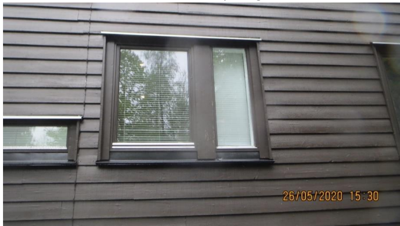
Sprekk i hjørnebord – Fuges tett nå, men kan skiftes på et senere tidspunkt.
