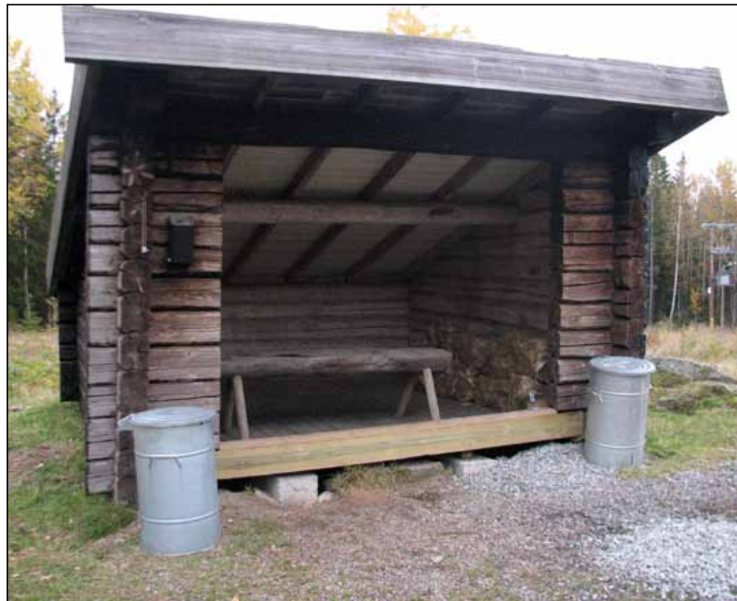
Gapahuken har fått ny bunnsville under inngangspartiet, da den gamle var helt rådden
