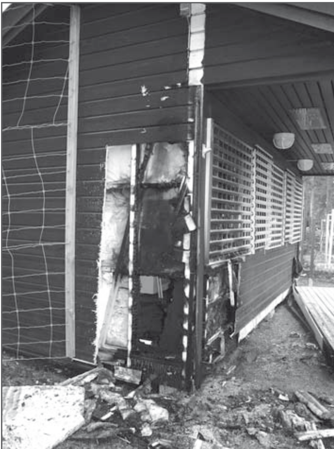
Kiosken hadde både brannskader og vannskader. Ny kiosk er under bygging.
