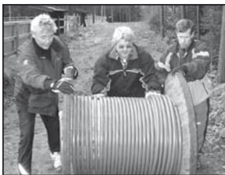
Strømkabel til snøpunkt
