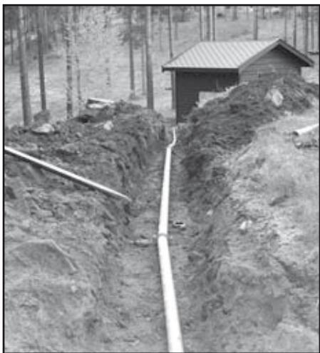
Rør til snøpunkt
